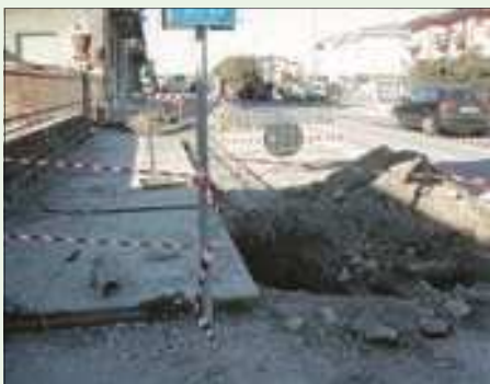
Situazione non regolare, il solo nastro non è suf- • non lasciare materiale o altro sul luogo ficiente per proteggere dalla caduta nello scavo di lavoro
