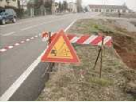
Situazione regolare, il ciglio della strada è pulito ed è presente idonea segnaletica
