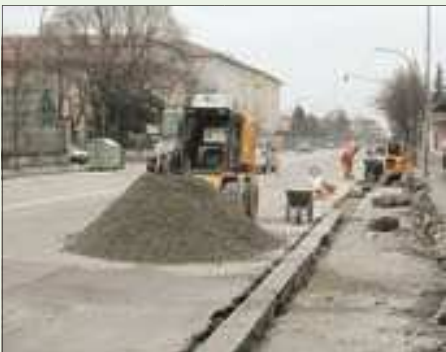
Situazione non regolare, manca la recinzione di
